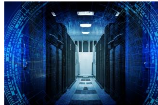
Edge & Cloud datacenters
